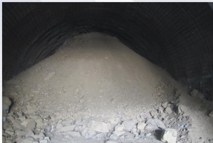
ریزش تونل در مرحله کفبرداری
