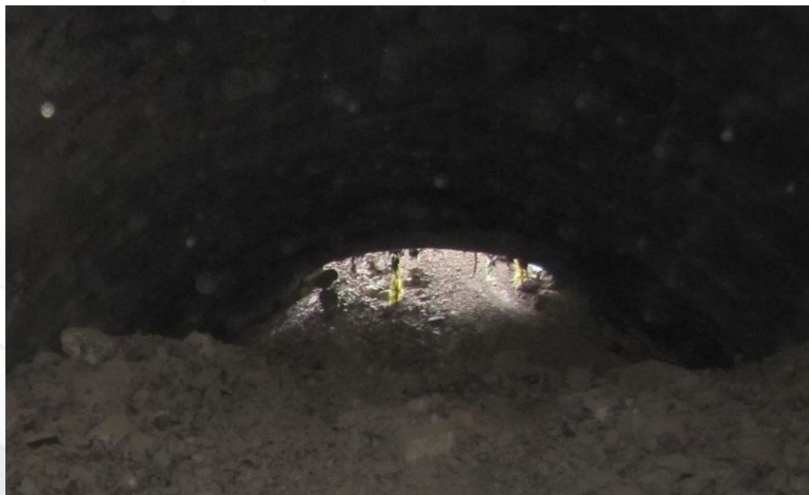
ریزش تونل در برخورد با واریزه ها در سقف
