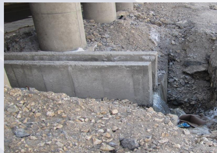
آب خروجی از کانالهای تونل
