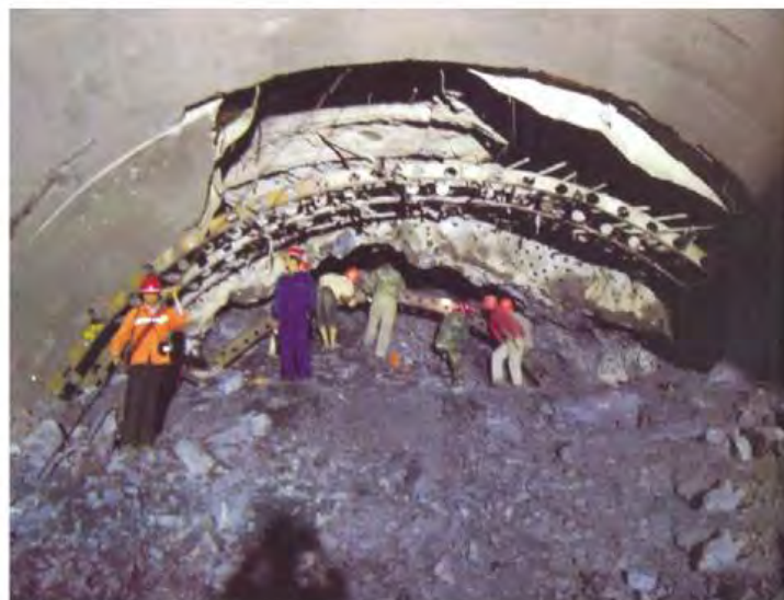
❖ ریزش پوشش تونل در محل تقاطع با گسل
