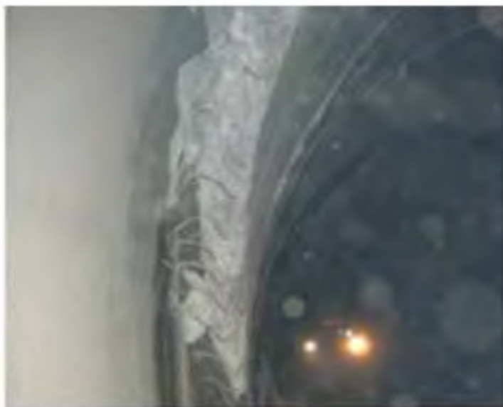
آسیب برشی در دیواره تونل
