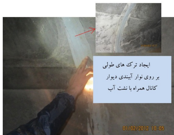
شکل (۸): تصاویری از آسیب سازه‌ای به کانال رباط کریم پس از نشست ۵ سانتیمتر روی سطح زمین
