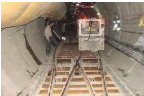
شکل (۲): کالیفرنیا سوئیچ نصب شده در پروژه تونل بلند زاگرس
