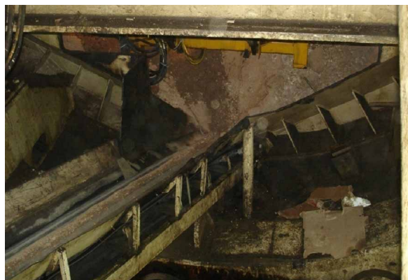
شکل ۱۵- سیستم تخلیه مصالح با استفاده از نوار نقاله
