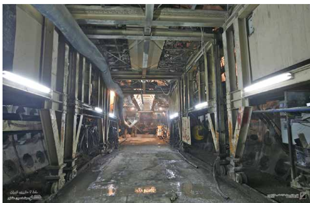
شکل ۱۰- محل قرارگیری پاور پک دستگاه حفار زوکور بر روی گنتری‌ها (کارگاه حفاری قطعه Q4-R4 خط ۴ متروی تهران)
