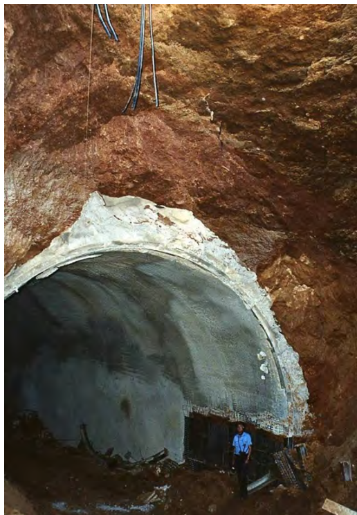
شکل ۹- حفره ایجاد شده در اثر ریزش (به اندازه فرد آتش‌نشان در قسمت پایین عکس توجه کنید)
